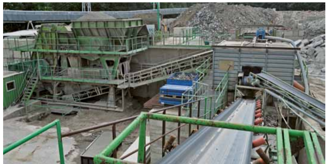
Industrieschmieranlage auf Brecher
